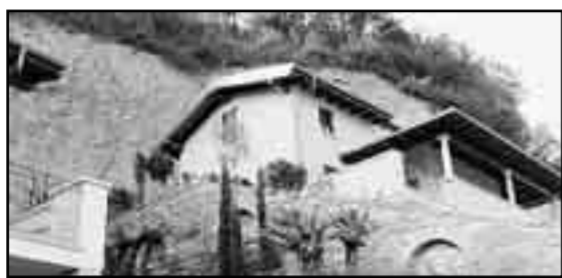
Una rete di protezione imbriglia la collina sbancata: la roccia incombe a strapiombo sulle due villette
